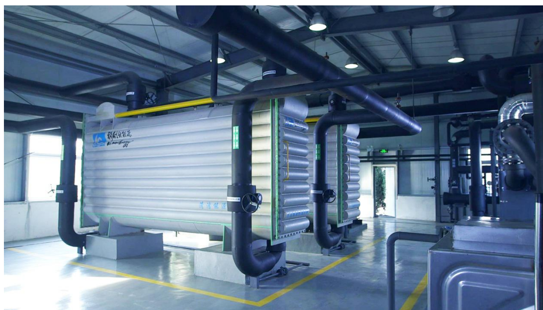
大型污水及地表水热泵供热系统
