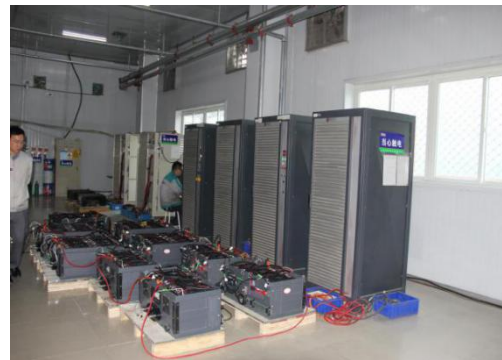
电池系统充放电测试柜
